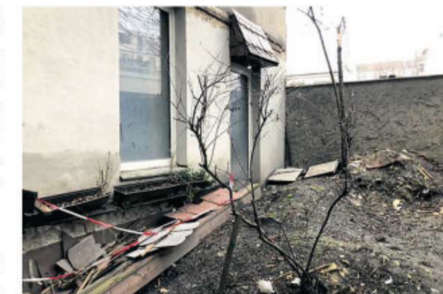
Die Pflanzen im Hof sind bei den Bauarbeiten kaputt gegangen. Reste von der Baustelle liegen immer noch herum.
