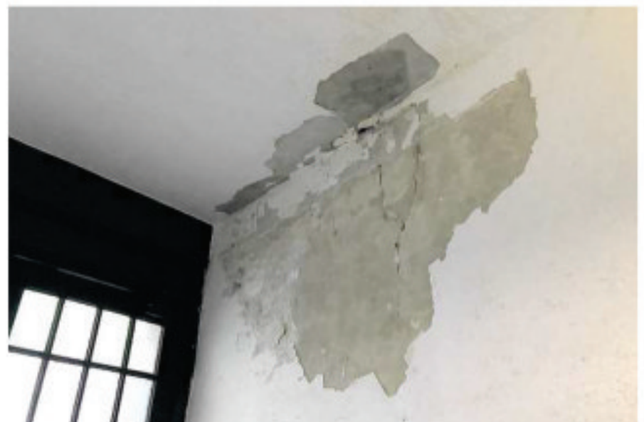
Der Wasserschaden in der Durchfahrt des Vorderhauses ist seit zwei Jahren nicht richtig untersucht worden.
